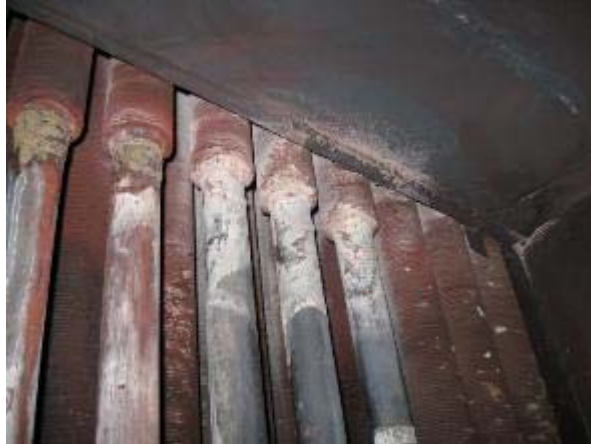
Photo 3.25.4 HRSG 1 Tube Leak
