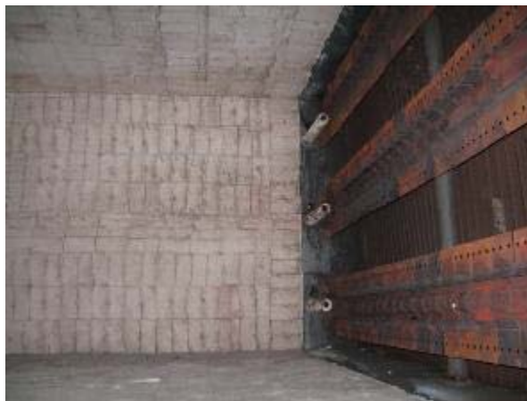
Photo 3.25.1 – HRSG 1 Duct Burner
